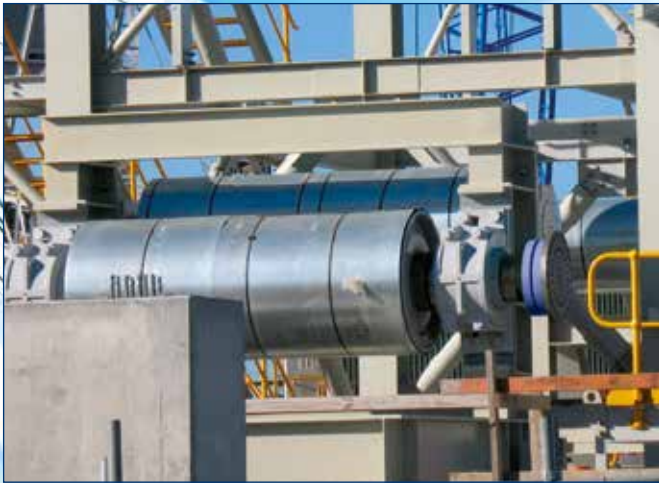
Polia de correia transportadora com anéis de fixação além de um anel de contração no lado do acionamento.
